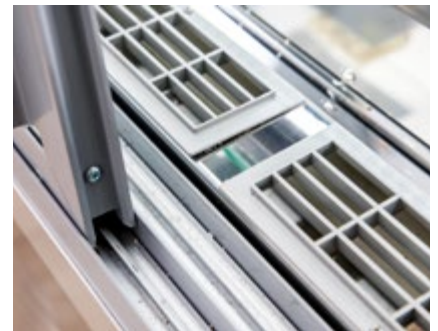
Laufschiene der Schiebetür und Luftführungsgitter
