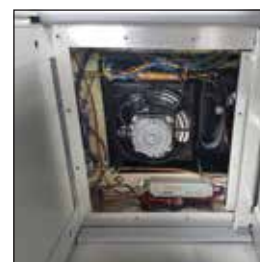
A5. Compartimento del condensador
