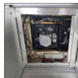
A5. Vano condensatore
